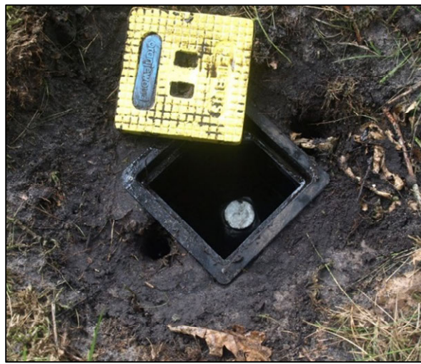
Figuur 6: schroefanker afgewerkt met een peilbuisput
