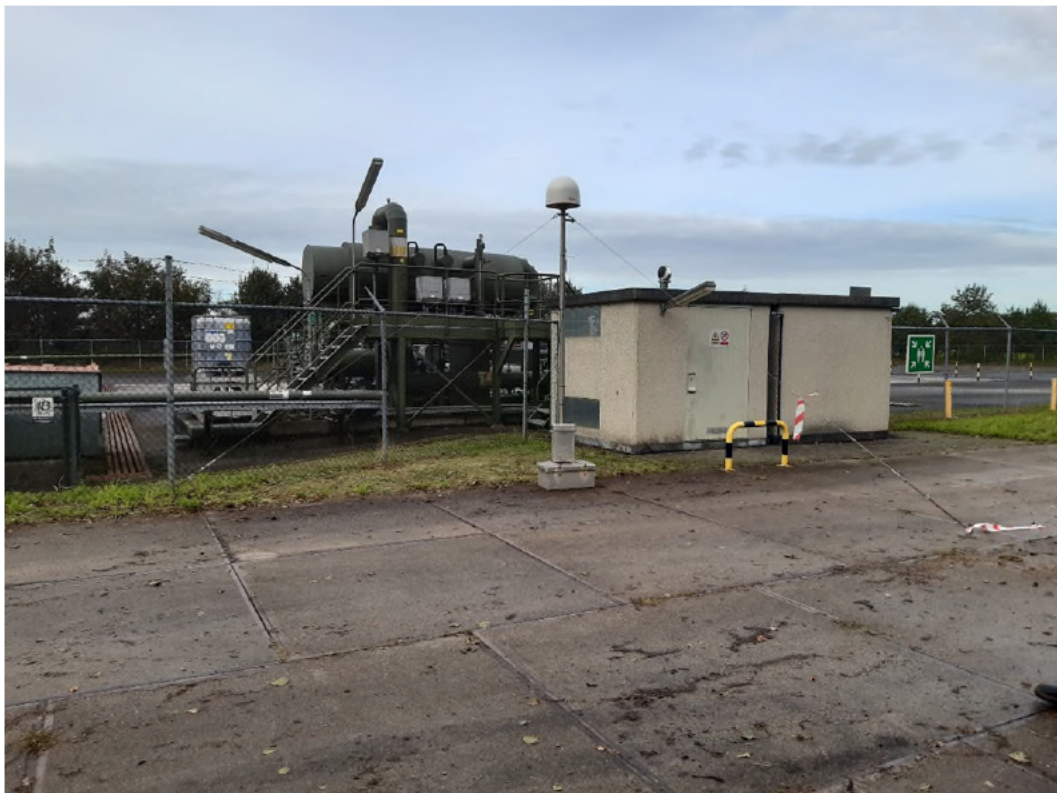
Meetopstelling meetpaal Vinkega
