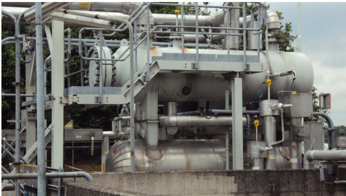
Figuur 11-3: Foto separator pakket op locatie Loon Op Zand.
