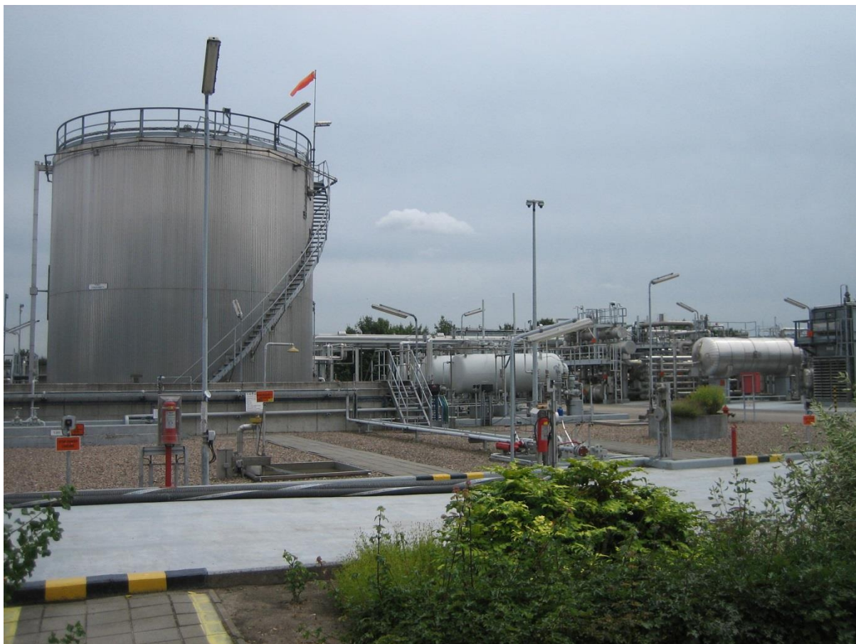
Figuur 11-3: Foto van het gas behandelstation.
