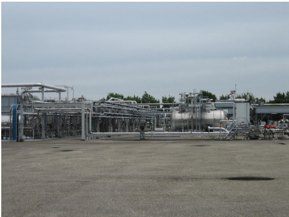
Figuur 11-4: Foto van het gas behandelstation.
