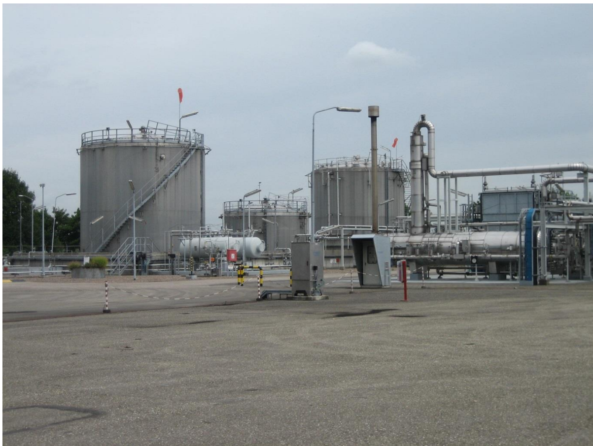
Figuur 11-5: Foto van het gas behandelstation.
