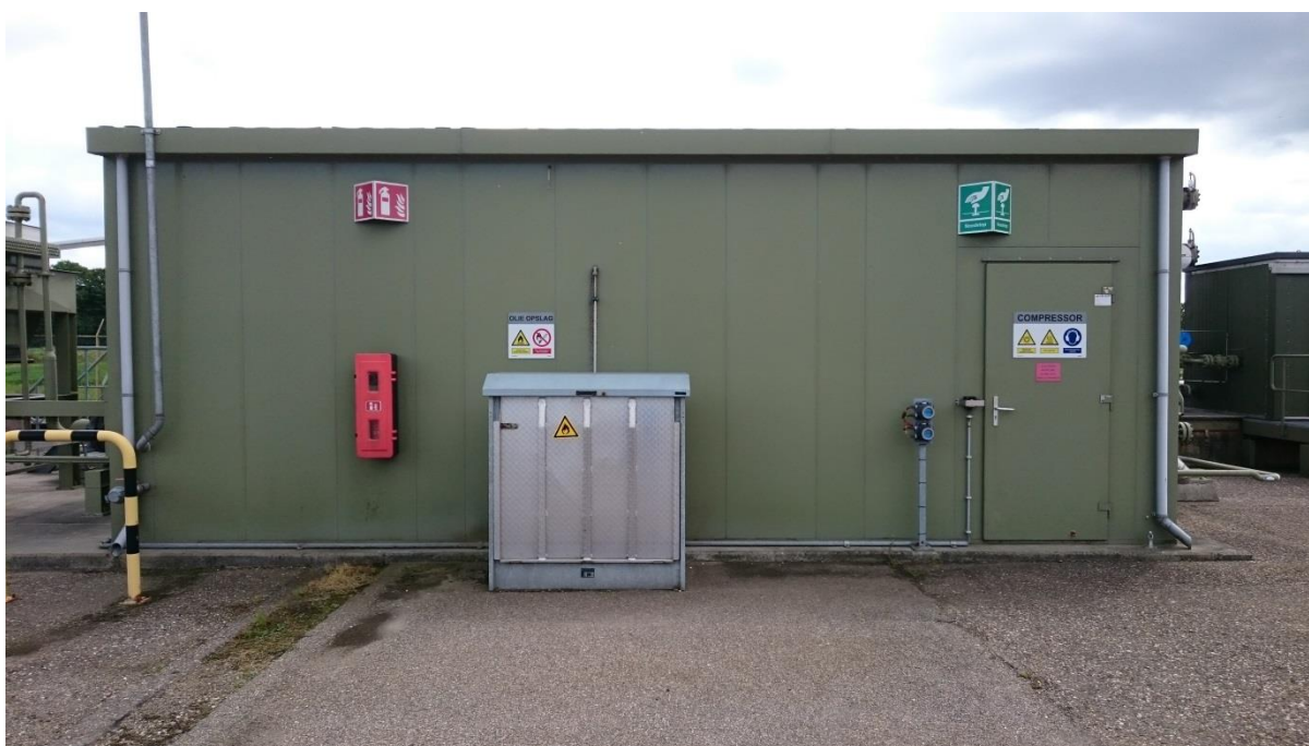
Figuur 13-6: Compressor gebouw op mijnbouwlocatie Slootdorp 1.
