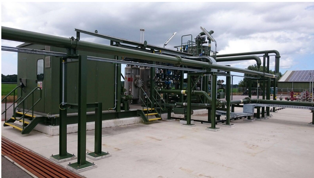
Figuur 13-5: Foto productie installatie en separator mijnbouwlocatie Slootdorp 1.
