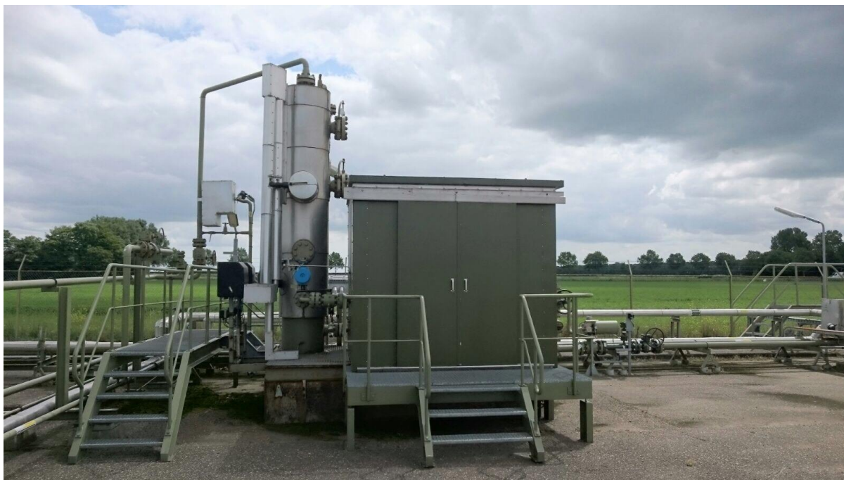
Figuur 13-11: Foto water injectie unit.
