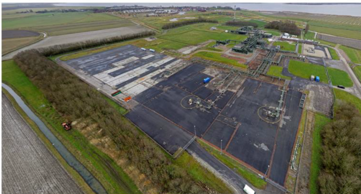
Figuur 3-2: Gasbehandelingsinstallatie Anjum-1 locatie.
