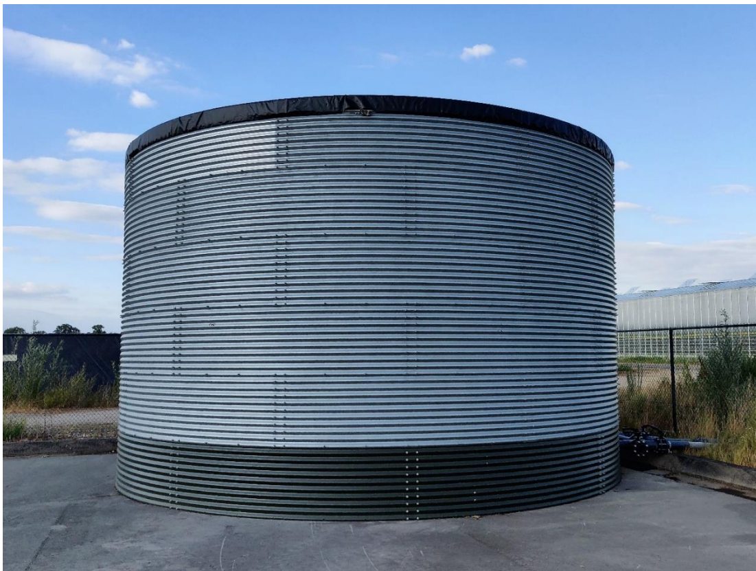
Figuur 30 : Opvang silo voor (regen)water op de mijnbouwlocatie.
